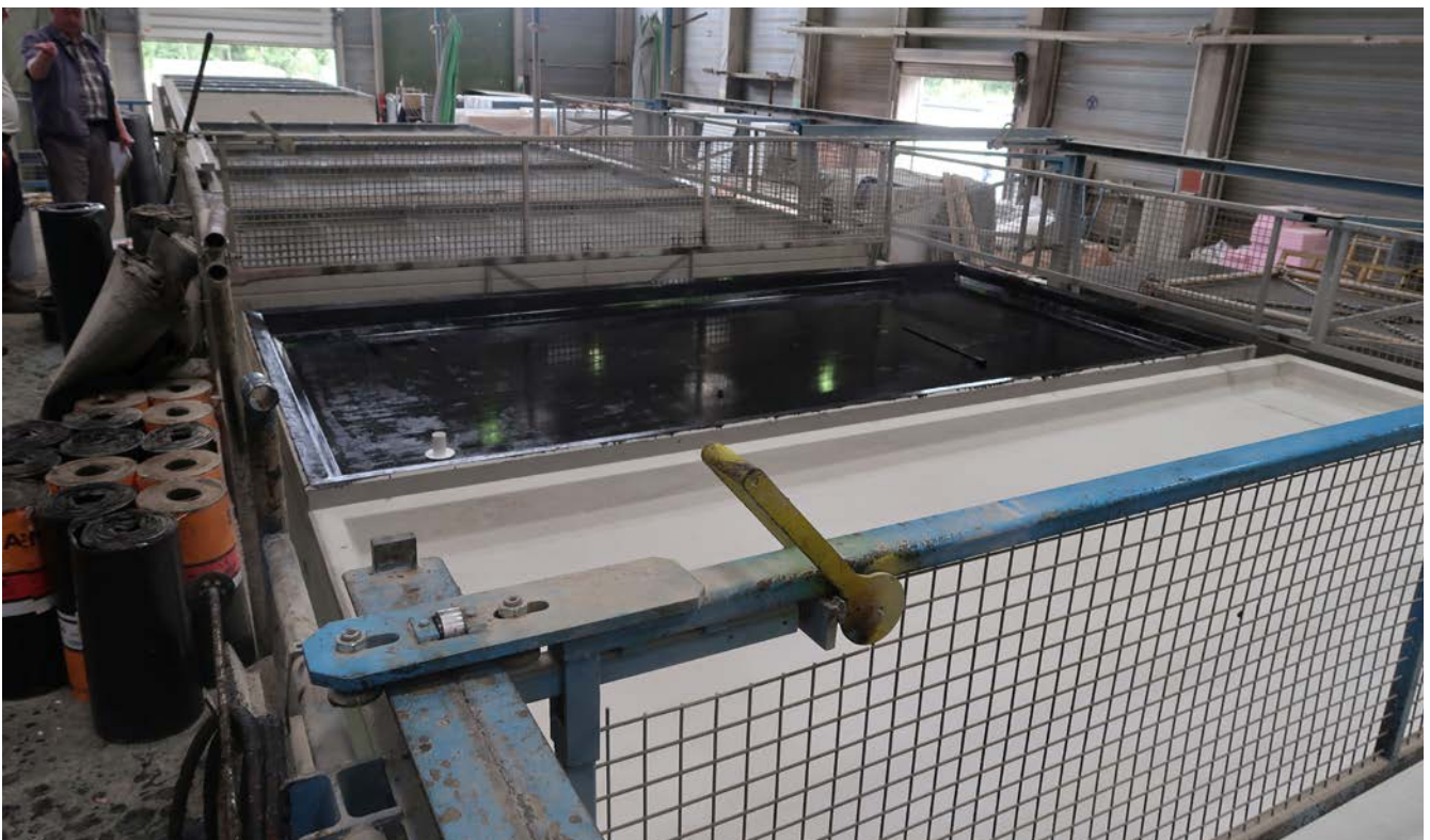
Abb. 85 bewegliche und arretierbare Schutzgitter oberhalb der Transportstrecke für Fertiggargen
