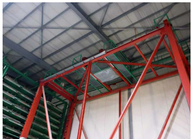
Abb.11 Arbeitsbühne für Wartungsarbeiten am Hubwerk des Regalbediengerätes
