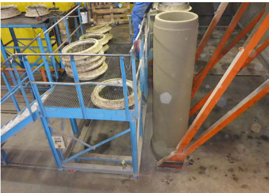
Abb. 47 Arbeitsbühne zur manuellen Nachbearbeitung
