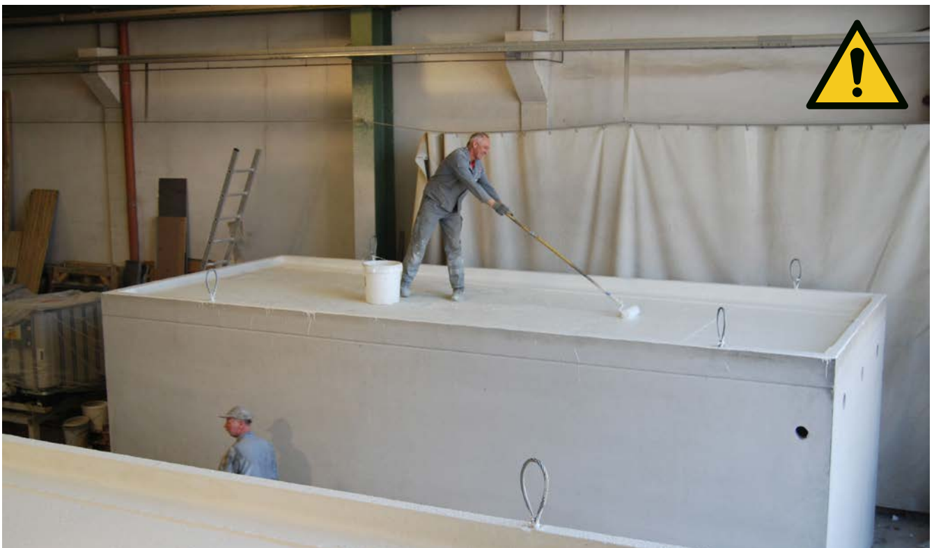
Abb. 87 NEGATIV: Arbeiten ohne Absturzsicherung
