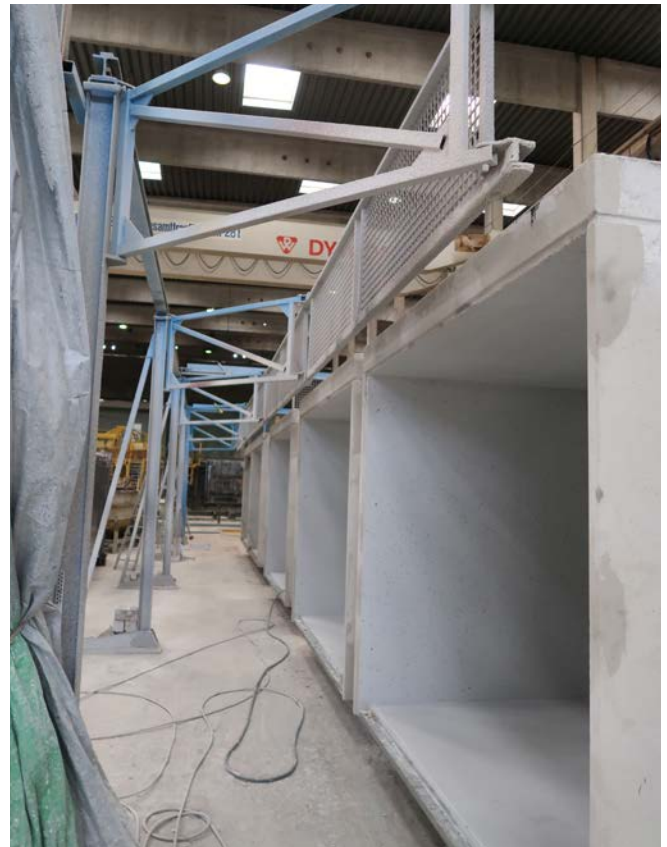
Abb. 86 In Abhängigkeit von der Länge der Fertigaragen heranschwenkbare Schutzeinrichtung gegen Absturz
